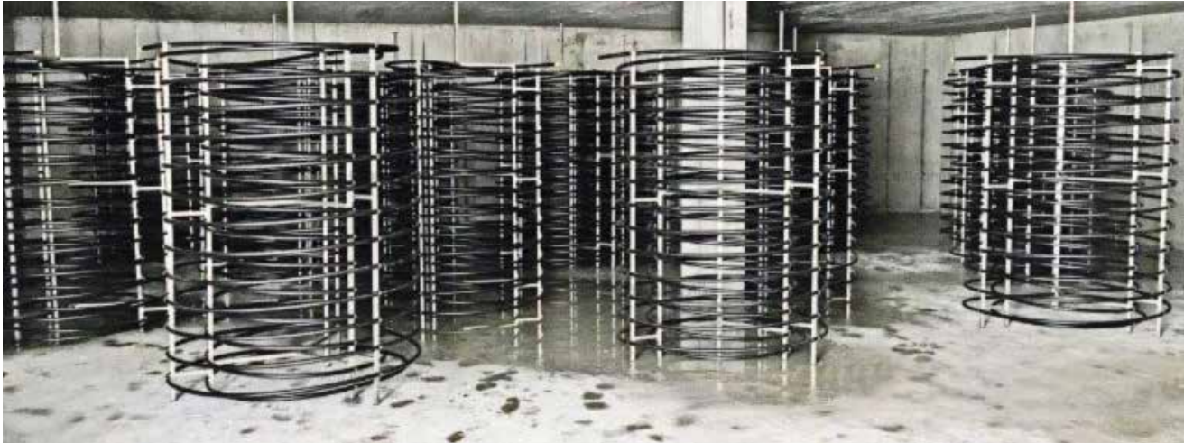
Wärmetauscher im Eisspeicher
